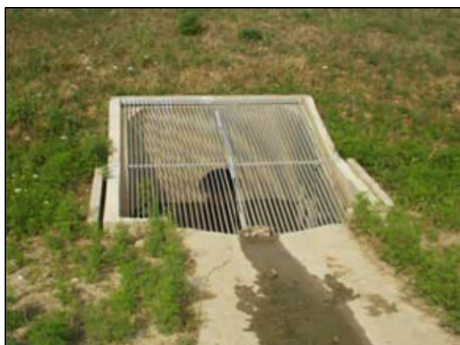
Figure 19 : Grille de protection sur ouvrage de sortie
